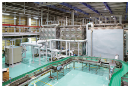
熱回収温水ヒートポンプと温水タンク。 タンクは、左から高温水、中温水、低温水と並ぶ。
